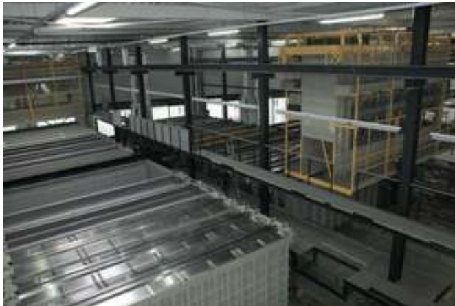
neue Badanlagen BWB Altenrhein AG
